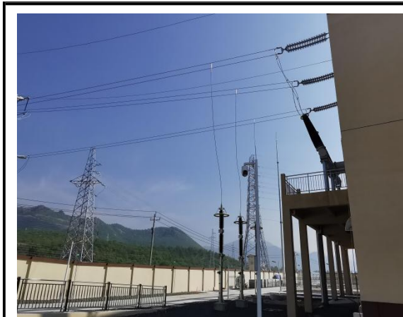
升压站出线间隔
